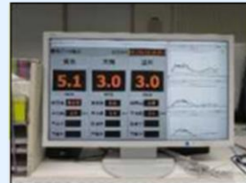
風向風速監視システム
