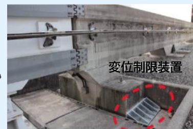
変位制限装置
