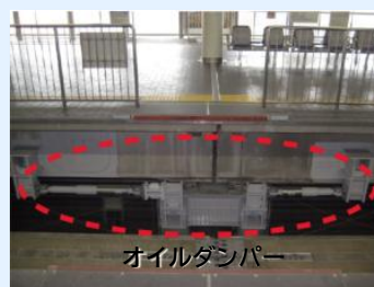
駅舎の制震装置
